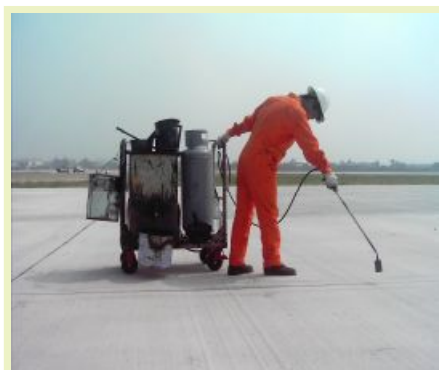
熔滲入填縫劑封閉槽底裂縫
