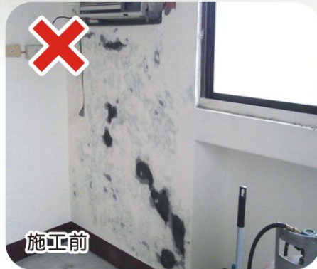
牆面無防水產生壁癌
