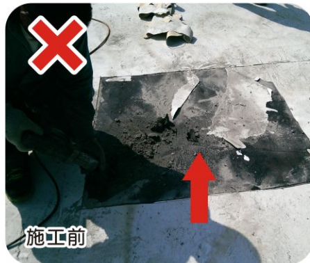
屋頂局部裂縫漏水
