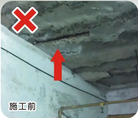
裂縫進水使鋼筋鏽蝕
