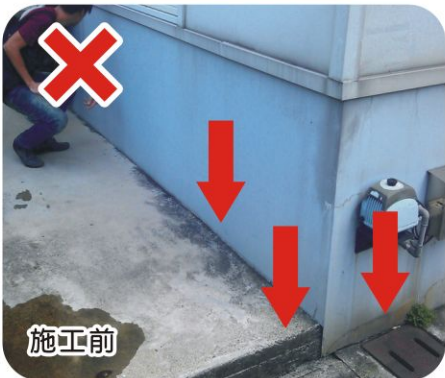
結構接縫屋內進水
