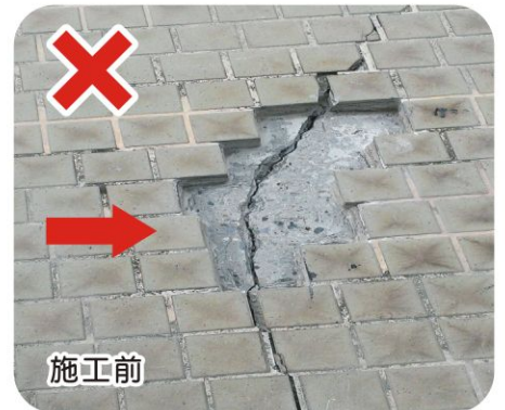
地板裂縫地下室漏水
